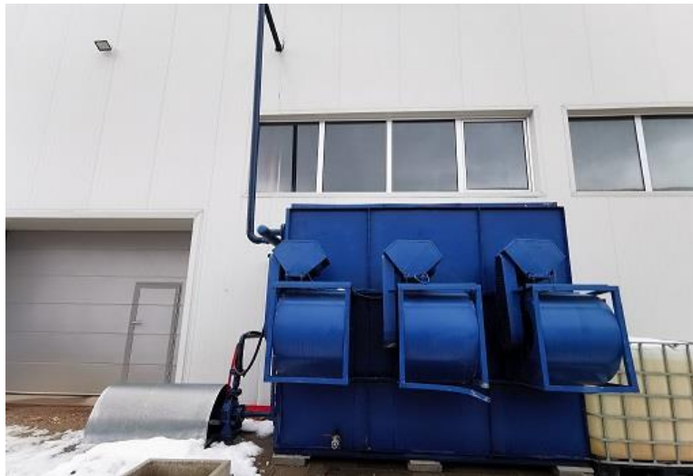
Слика II-13. Разладен систем (Chiller)
