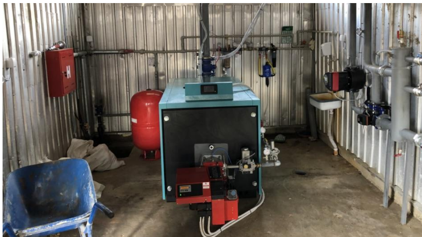
Слика 37 Топловоден котел во техничка просторија на одгледувалиште
