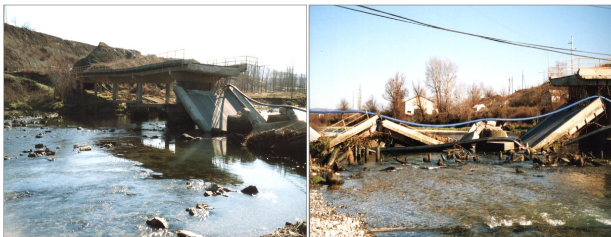
Слика 26: Срушен мост на Црна Река кај с. Росоман. (Извор: Цв. Поповска, 2005)
