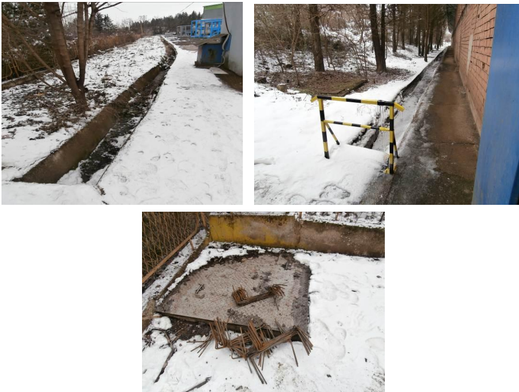
Слика 24 Бетонски канали за собирање на атмосферските води и собирна шахта
