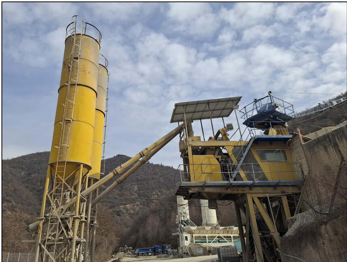
Слика II.1: Бетонска база - ELBA 50
