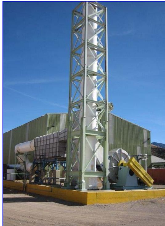
Слика бр.VI-2: Испуст од системот за прифаќање на киселинска магла
