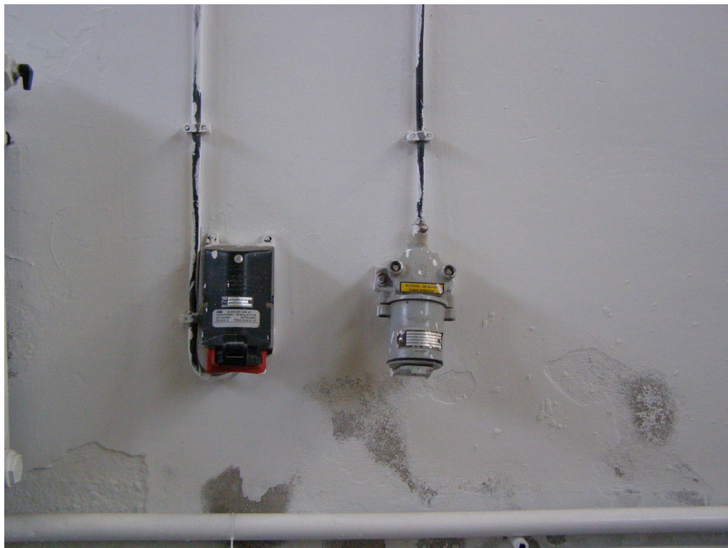
Слика 12.1 Електрична инсталација
